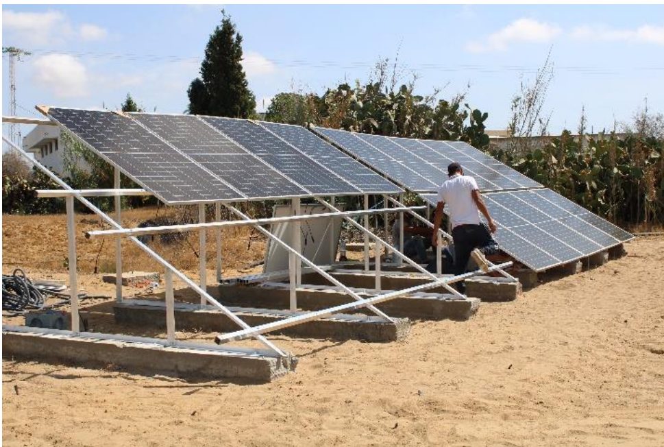
Figure 7. Utilisation des panneaux solaires photovoltaïques pour l'alimentation du pilote de traitement
